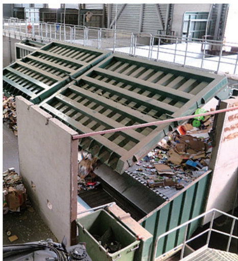
回収資源投入口
